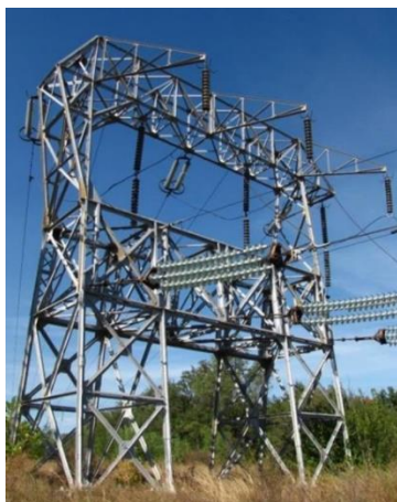
в) кінцева опора лінії 150 кВ
