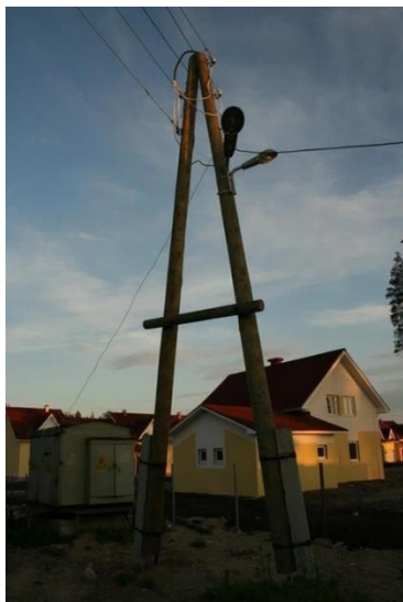
Рисунок 2.8 – Дерев'яна опора повітряної лінії 0,4 кВ
