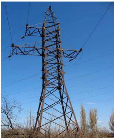
Рисунок 2.10 – Металева анкерна кутова опора повітряної лінії 35 кВ
