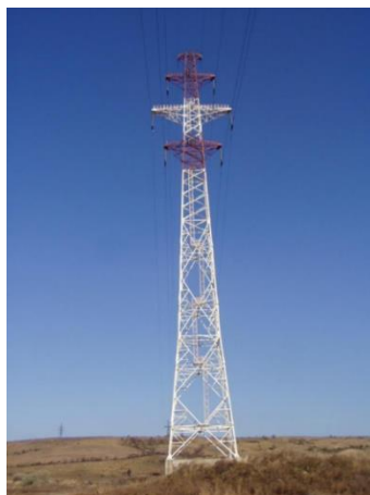
г) перехідна опора лінії 110 кВ
