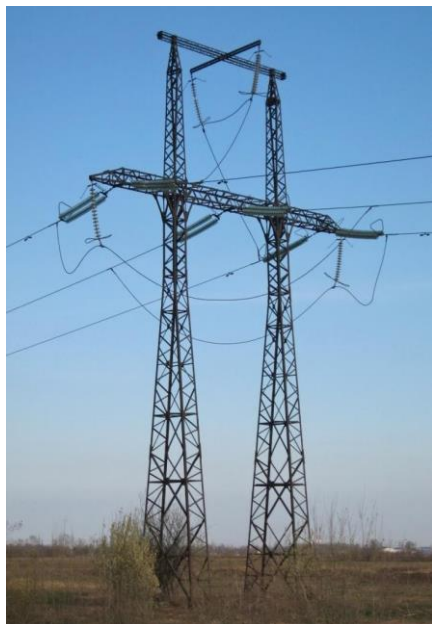
а) транспозиційна опора лінії 110 кВ
