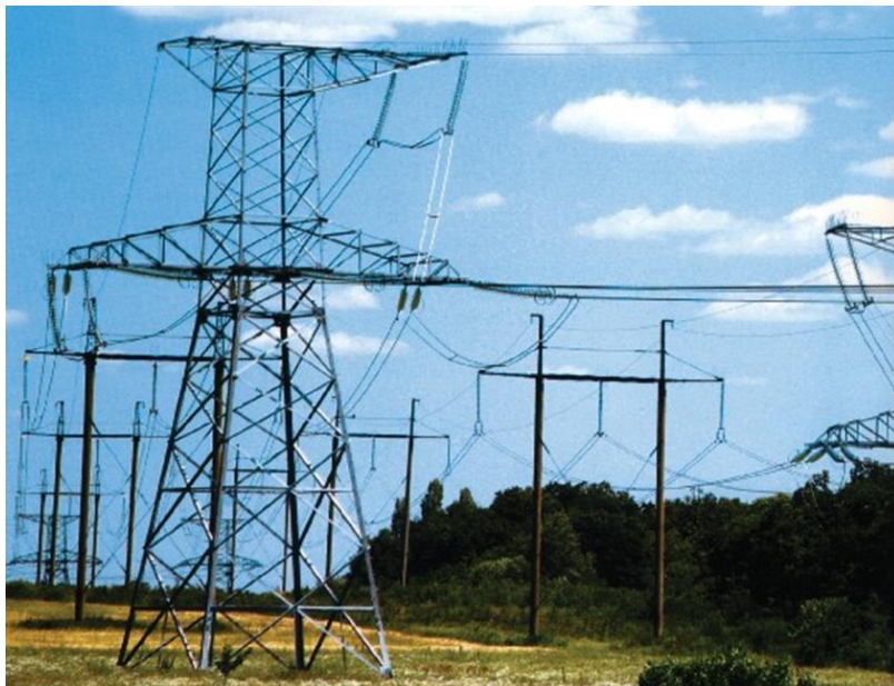
Рисунок 1.9 – Повітряні лінії електропередач
